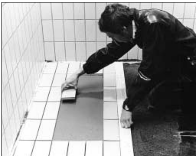
6. Kada se višak vode apsorbuje u cementnoj košuljici i kada cementno mleko postane mat izgleda, pločice je potrebno postaviti na osnovu oznaka na mernoj letvi.
